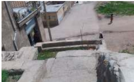
شکل ۱۴- عدم سهولت دسترسی در برخی مسیرهای پیاده به دلیل نامناسب بودن مصالح (کشتارگاه، ۱۳۹۳)
