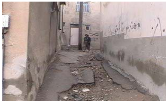
شکل ۱۵- عدم پوشش مناسب مسیر دسترسی پیاده در محل (تپه مالان، ۱۳۹۳)
