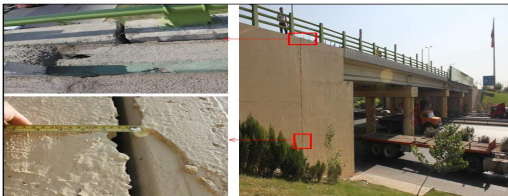
شکل شماره ۶: تصویری ایجاد درز و شکاف در پل بزرگراه آیت الله سعیدی ناشی از پدیده فرونشست (عکس: نگارنده)
